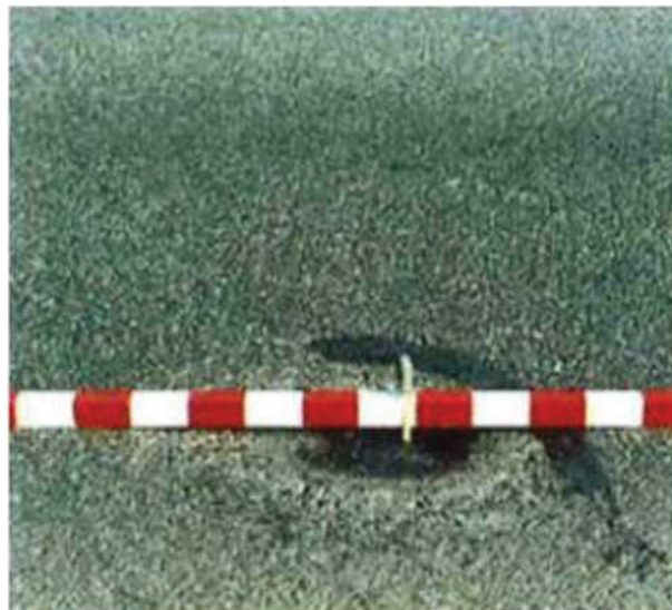
fig.II.3 : L'affaissement hors rive
