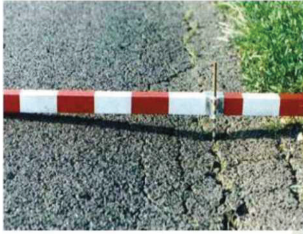
fig.II.2 : affaissement de rive
