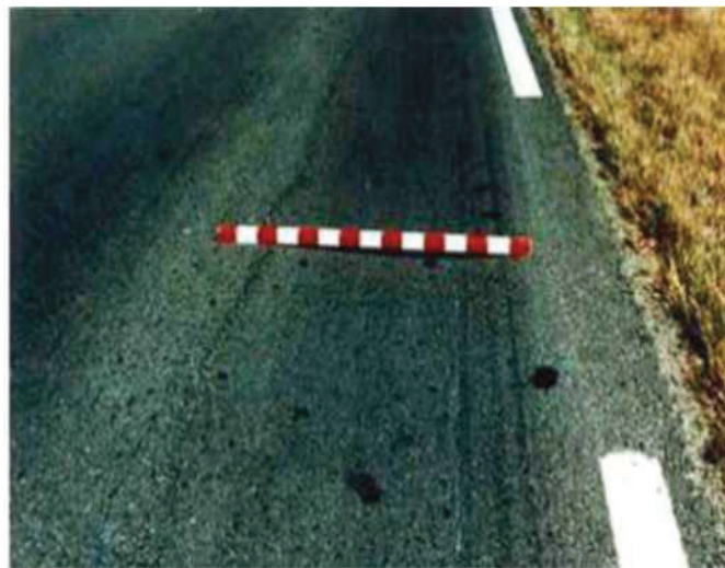
fig.II. 1 : orniérage d'une chaussée
