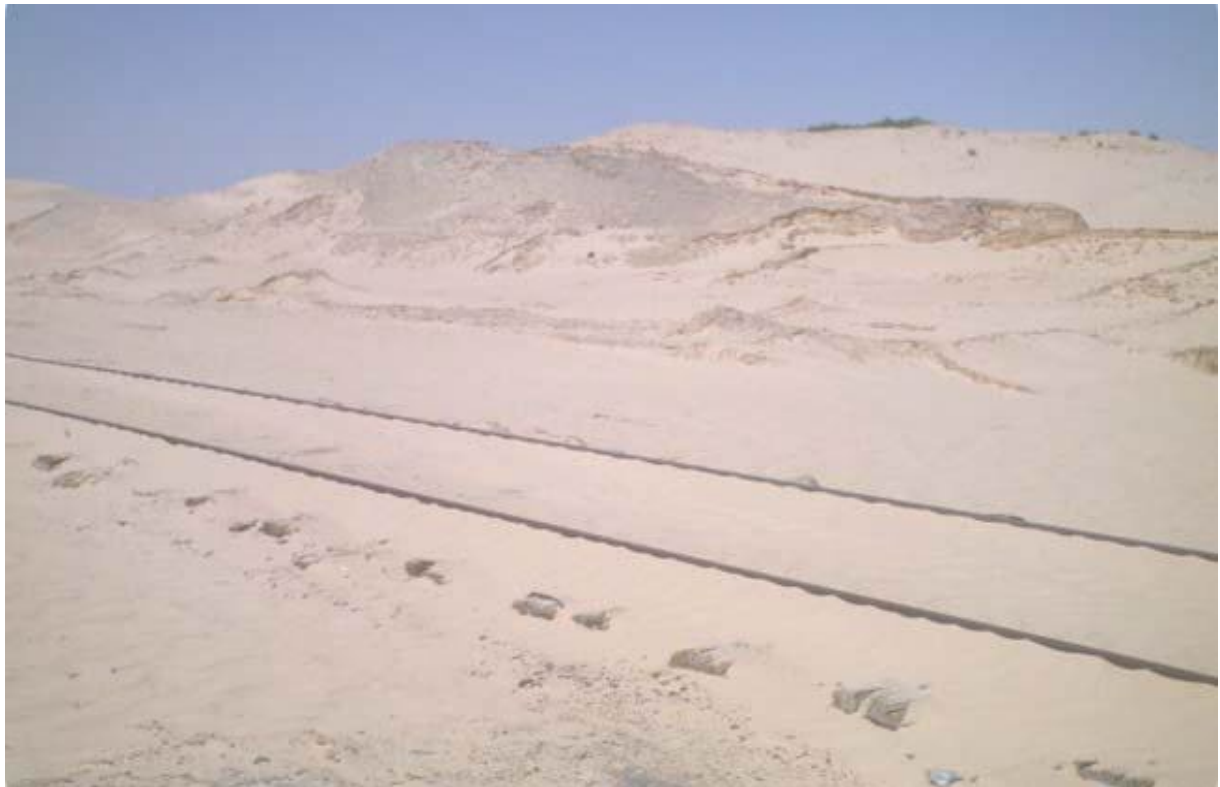
Figure I:5 Epannage de dérivés de pétrole (bitume) pour protéger la voie ferrée contre l'ensablement (Biskra_ Touggourt) Fixation biologique
