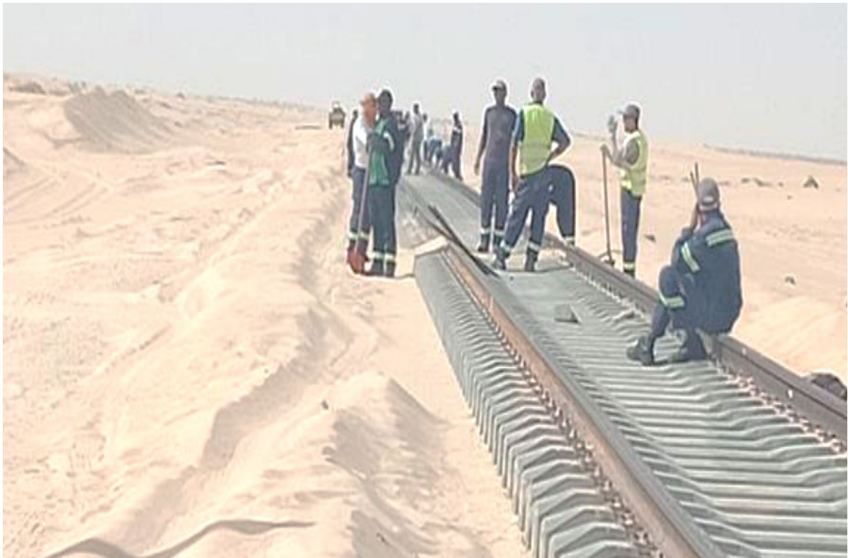
Figure I:2 Désensablement de la voie ferrée
