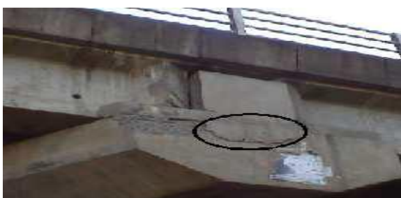
Fig I.24 : Epaufrure due par pression de corrosion [53]
