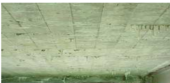
Fig I.22 : Efflorescence de dalle du pont [81]
