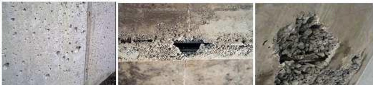
Fig. I.30 : Défaut de mal exécution des travaux [7]
