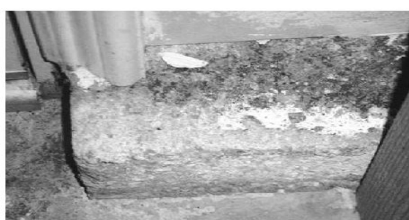
Fig I.6 : L'effritement et l'efflorescence [64]
