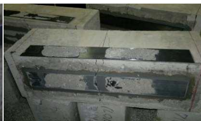
Fig.14 : une poutre dont le renfort en fibres de carbone s'est décollé [18]
