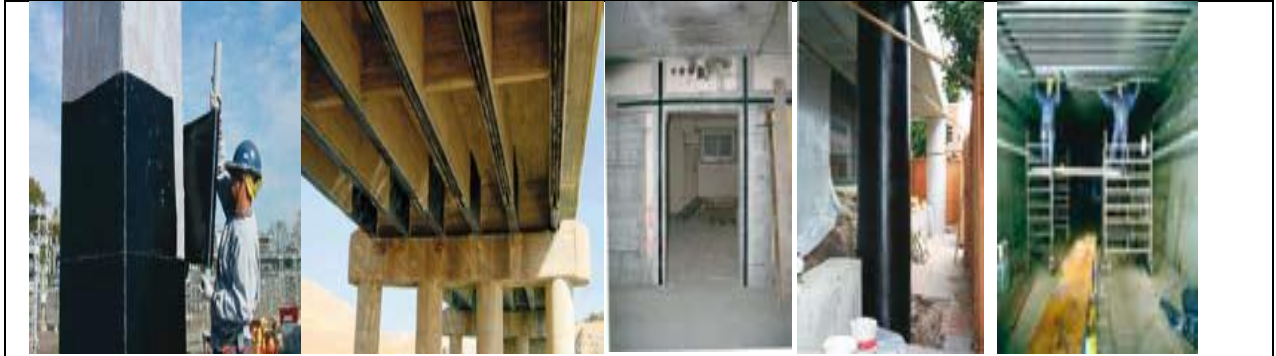
Fig. IV.3 : Renforcement d'infrastructures existantes de bâtiment, ouvrages d'art et génie civil : Poutres / poteaux / trémies / dalles / voiles [76]
