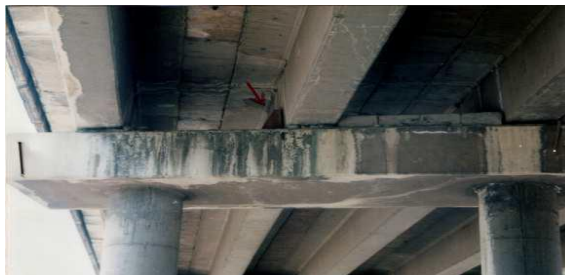
Fig I.23 : Efflorescence au niveau de chevêtre [81]
