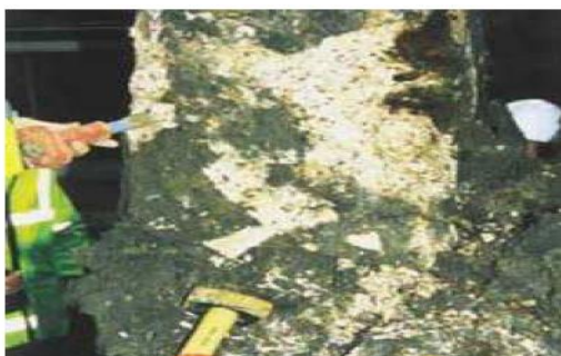
Fig I.5 : Dommages causés par la thaumasite [64]
