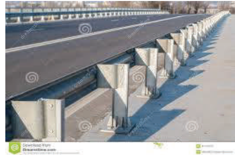
Figure IX.5. Glissières de sécurité galvanisée
