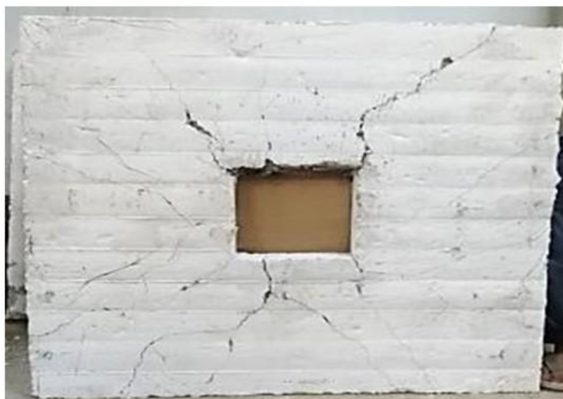
Figure I.21 : Fissuration de la dalle a cause d'ouverture [13]
