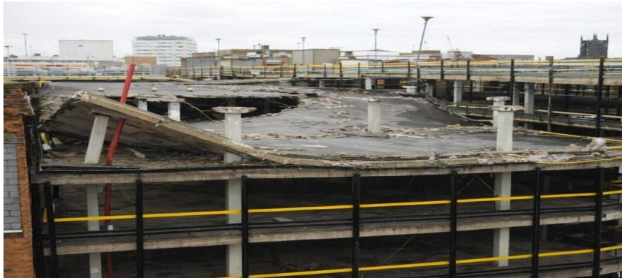
Figure I.20 : Le parking de Pipiers Row après les défaillances progressives par cisaillement [13]
