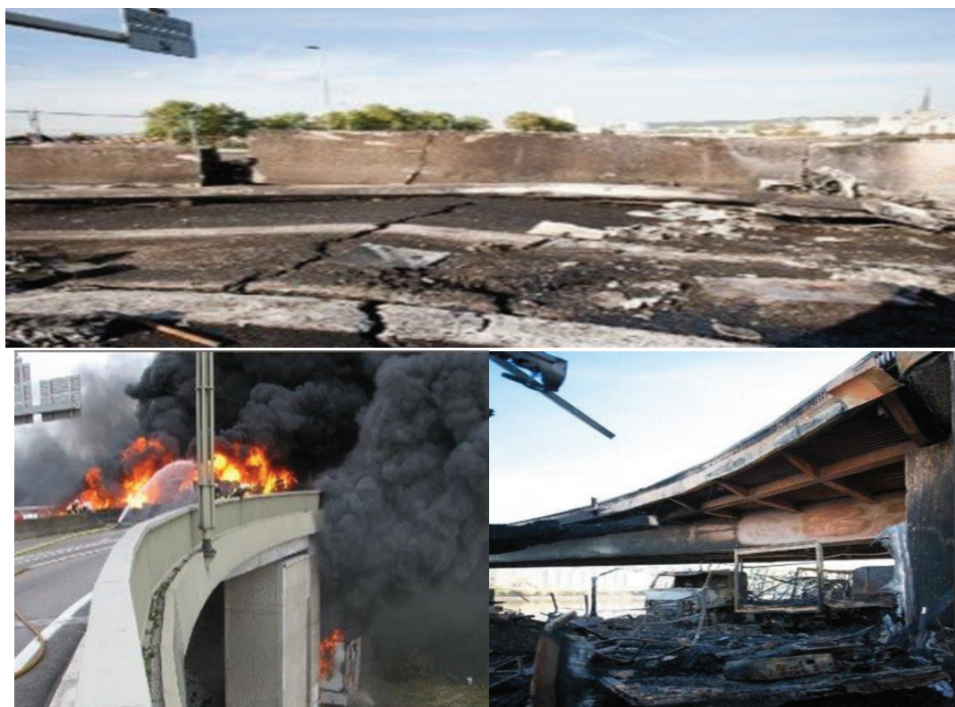
Figure I.1 l'incendie dans le pont
