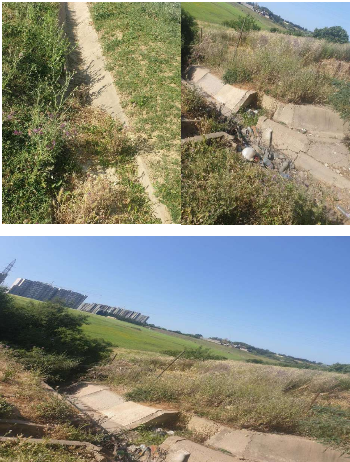
Figure VII-13: Dysfonctionnement des ouvrages d’assainissement longitudinal, mai 2022.
