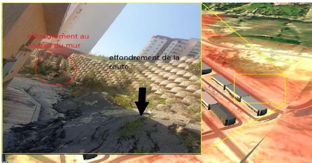
Figure VII-17 : Glissement de terrain en périphérie du bloc 07, 2022.
