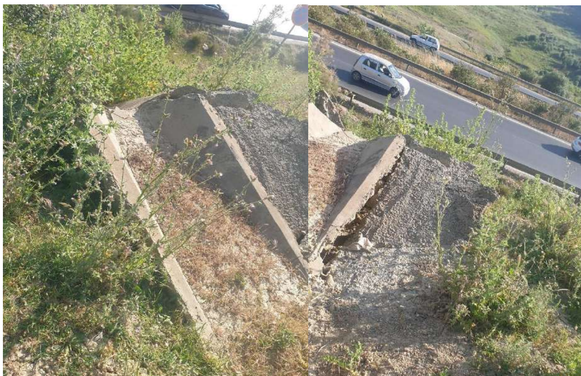
Figure VII-14: Bassin de décantation entièrement bouché, mai 2022.
