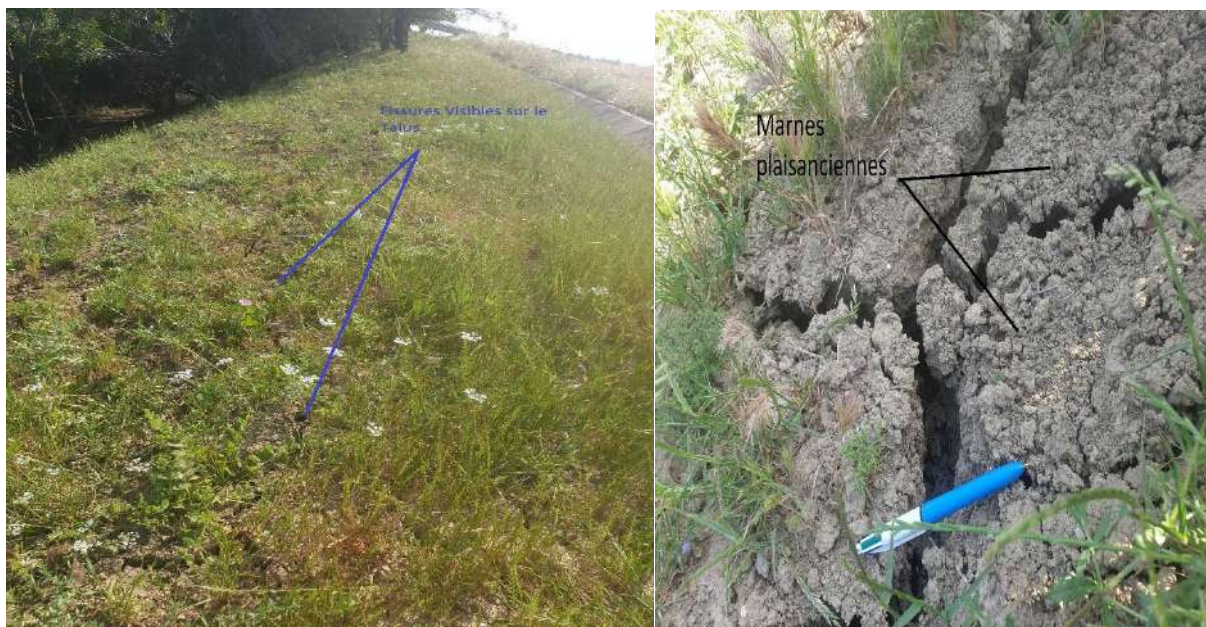
Figure VII-4: Apparition des fissures avec ordre de grandeur, mai 2022.
