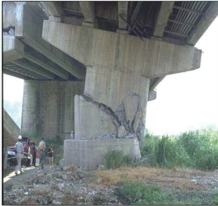
Figure 1.6 : Rupture des piles par cisaillement lors du séisme de Chi-Chi (Taiwan, 1999)
