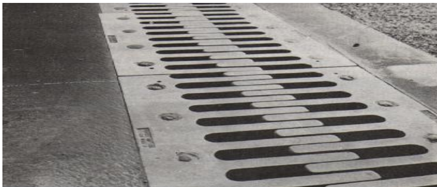
Fig. IX- 6. Joint de chaussée.
