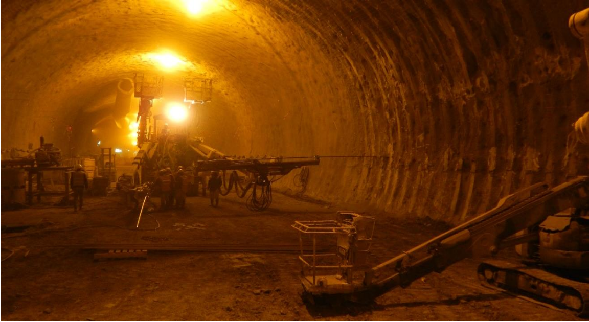
Figure 35: La mise en place des boulons d'ancrages à la paroi du tunnel.
