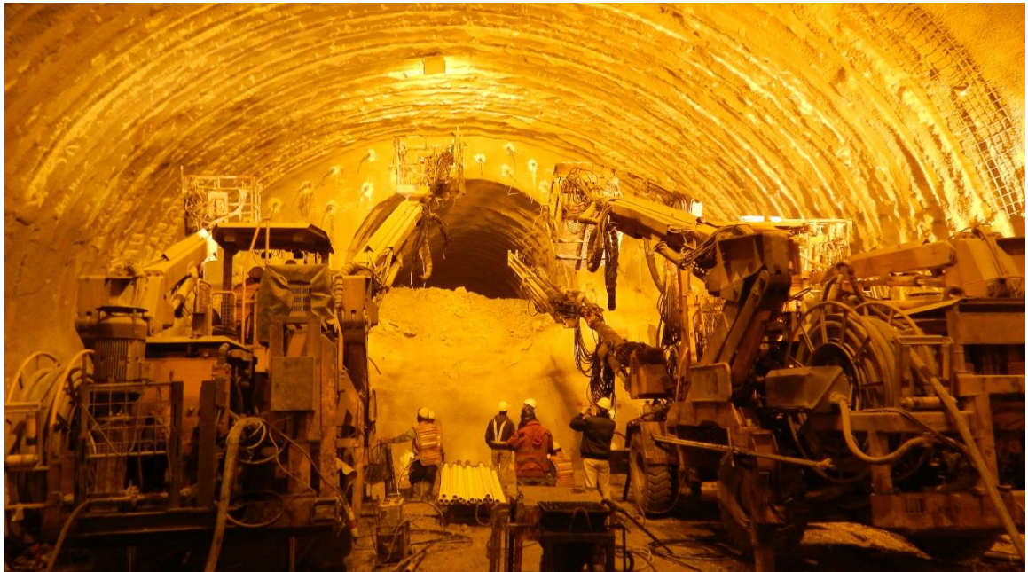
Figure 34: Front de taille du tunnel T4, soutènement provisoire déjà placé dans la partie excavé , et des jumbo de 2 bras et de 3 bras pour la mise en place les tubes GFRP.
