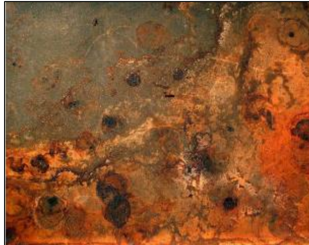
Figure M. 1. Tôle métallique corrodé
