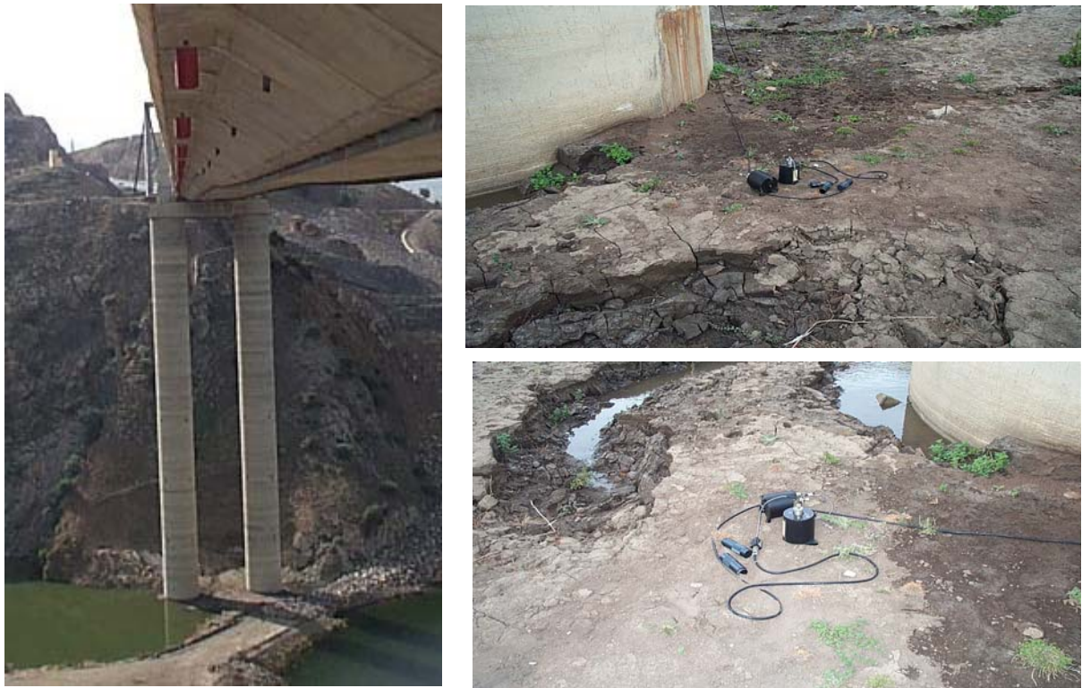
Figure V.14: Mesure de la fonction de transfert du fût du pylône (côté Constantine)
