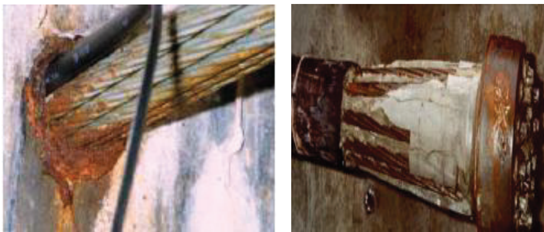
Figure I.1. Système d'ancrage attaqué par la corrosion
