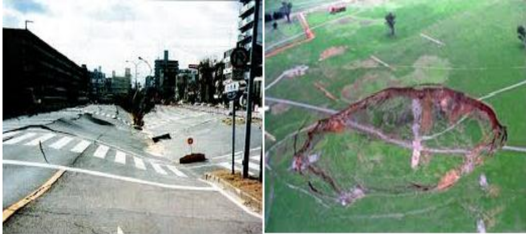
Figure I. 4 : Problème de tassement en surface.
