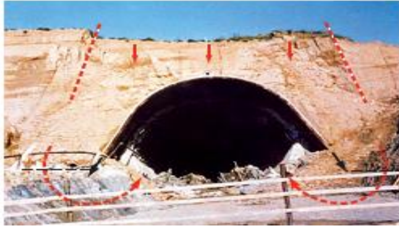
Figure I. 2: Glissement de talus de portail de tunnel.
