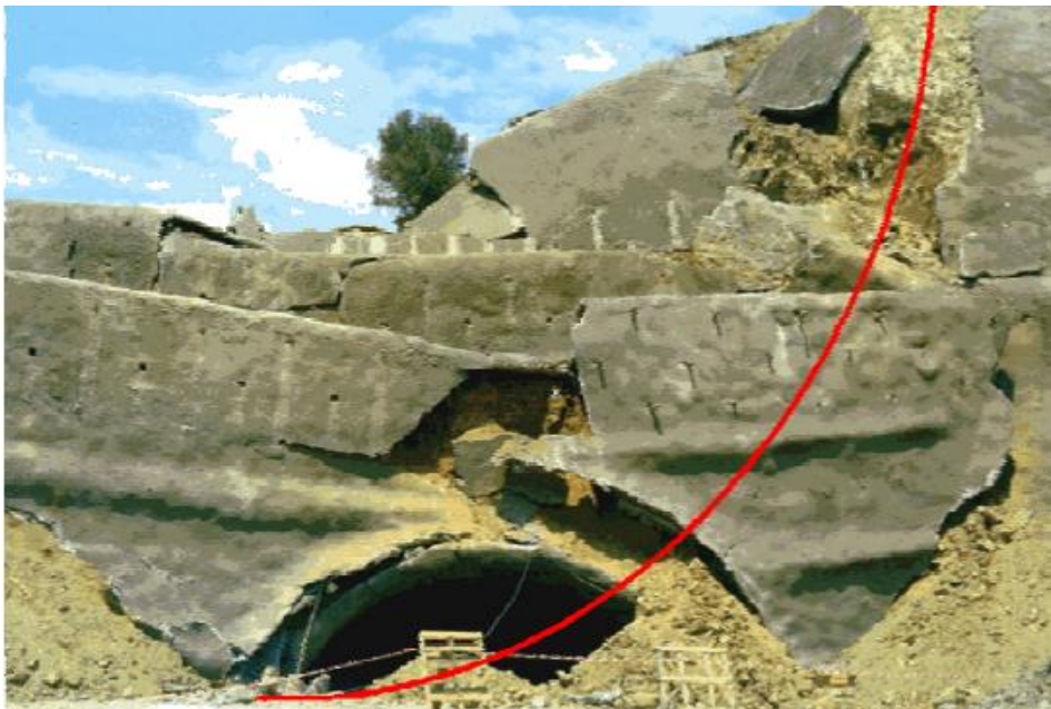
Figure I. 1 : Effondrement en tête de tunnel.
