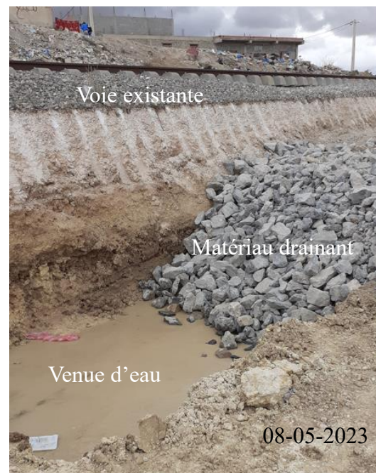
Figure IIX - 2 Substitution avec un matériau drainant au PK 02+400
