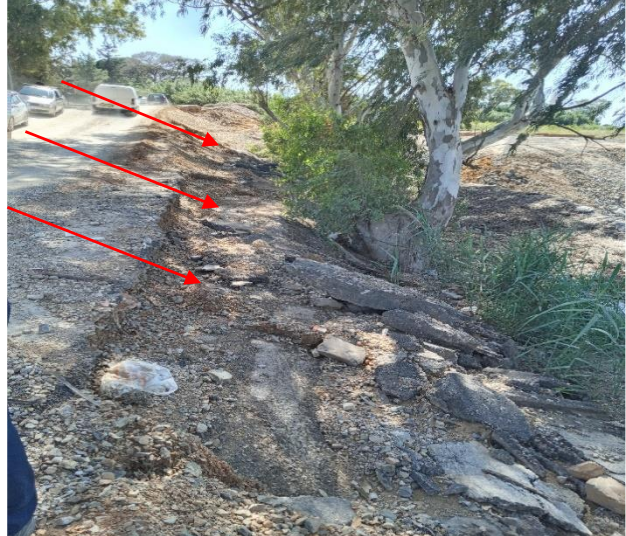
Figure II-7 : Talus aval instable malgré le dispositif de soutènement en gabions mis en place.
