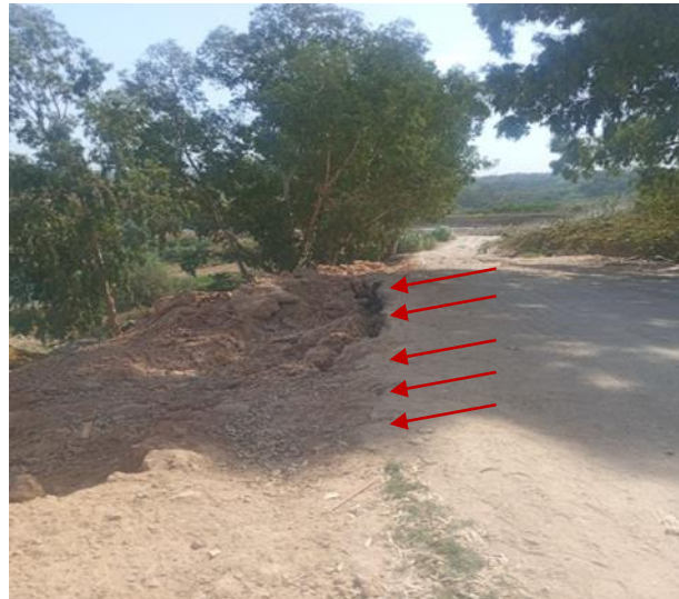
Figure II-11 : dégradation de la chaussée côté de CHERAGA avec mouvement de terrain accentué vers l'aval.
