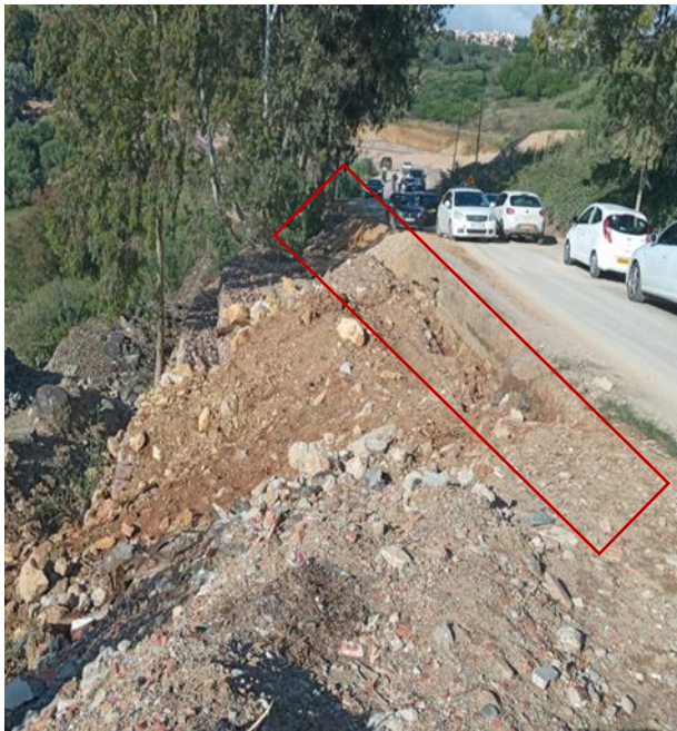
Figure II-6 : rupture de talus en aval coté de CHERAGA, inefficacité du gabion.
