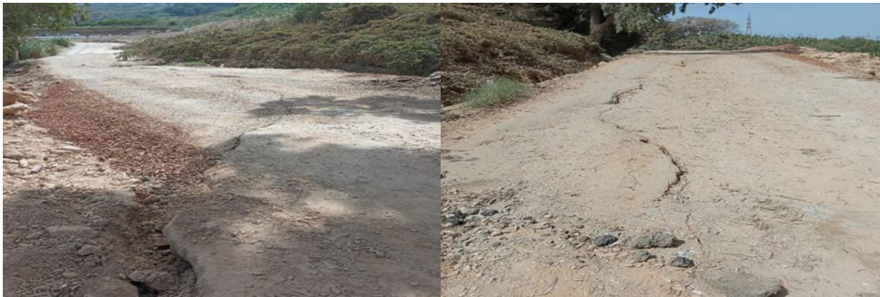
Figure II-10 : Coté Cheraga après rechargement de la route, réapparition de la rupture.
