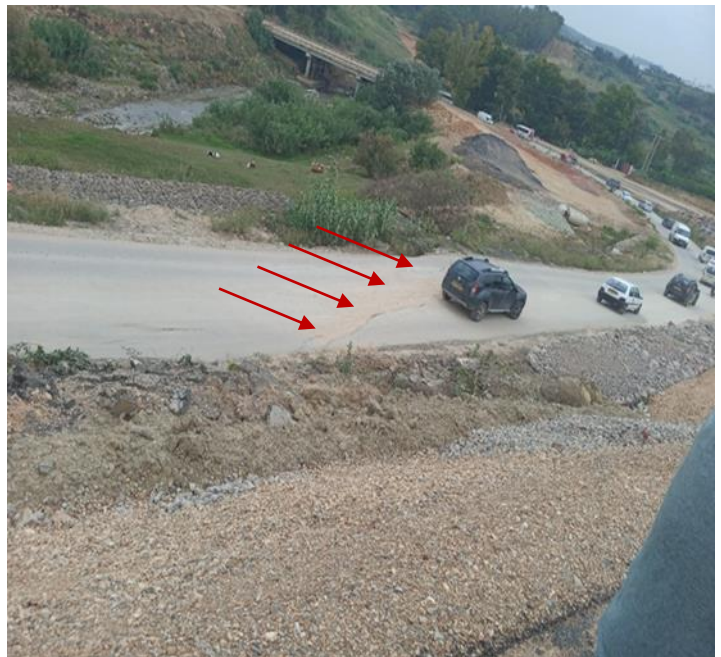
Figure II-5 : limites de glissement coté AIN BENIAN.
