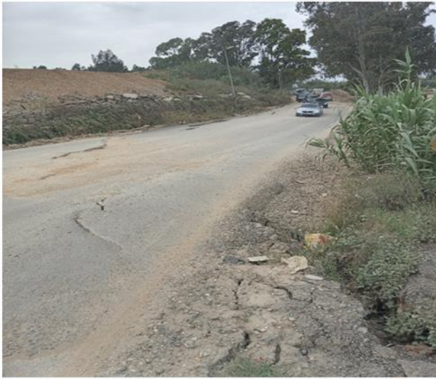
Figure II-8 : Route dégradée, affaissements, et déformations accentuées coté de AIN BENIAN.
