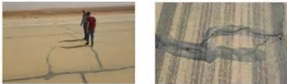
Figure III.1 Fissures longitudinales et transversales
