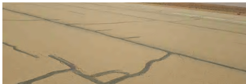
Figure III.3 Fissures longitudinales sur l'axe de la piste
