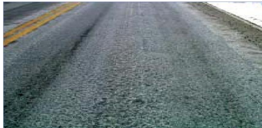
Figure 13: Désenrobage et arrachement
