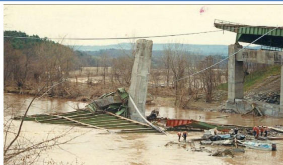
Figure I.2 : Importance du Phénomène de l'Affouillement.
