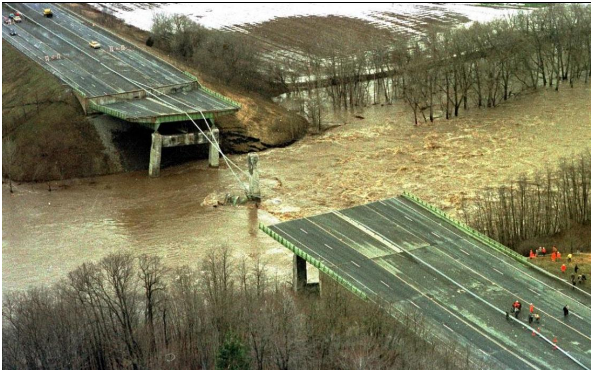
Figure I.11 : Pont de Schoharie Creek-New York, Etats-Unis (1987).
