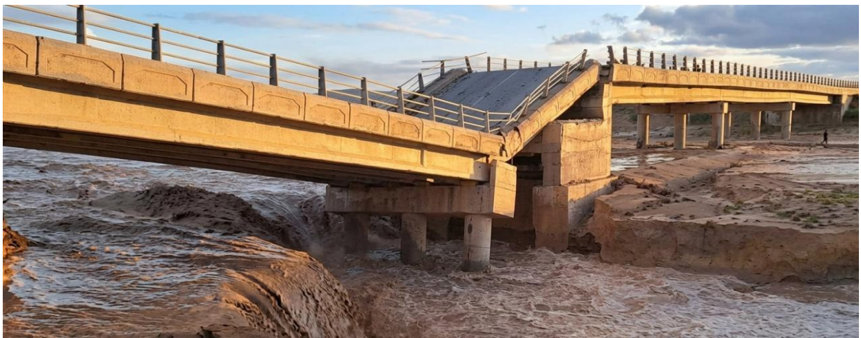
Figure I.1 : phénomène de l'Affouillement Commune d'El Maârif, Wilaya de M'Sila,
