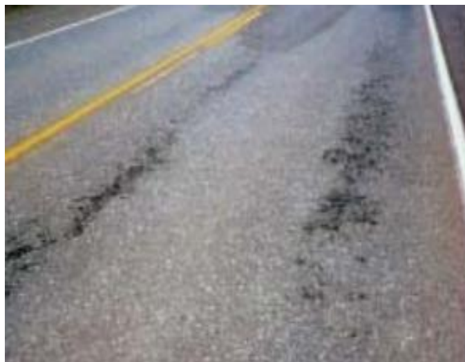
Figure I.4: Dés enrobage et arrachement.
