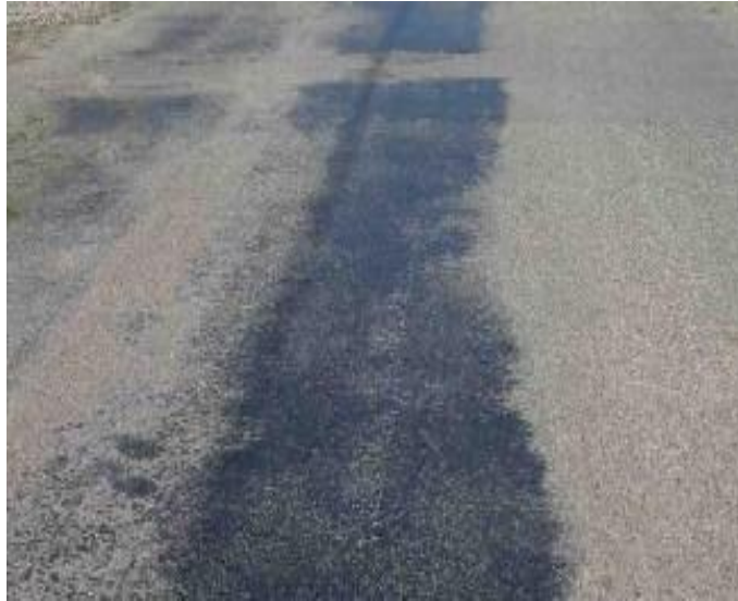
Figure I.5 : Ressuage de la chaussée.
