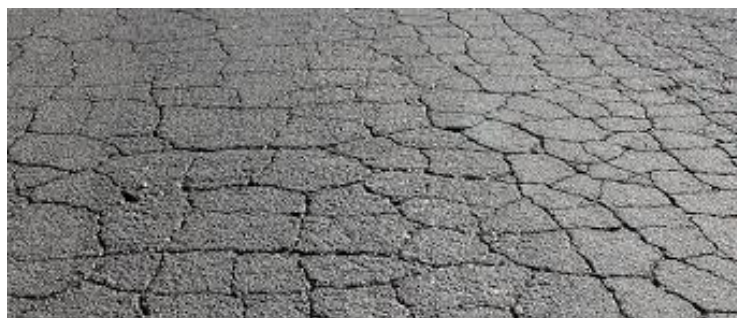
Figure I 3 : Faïençage de la chaussée.
