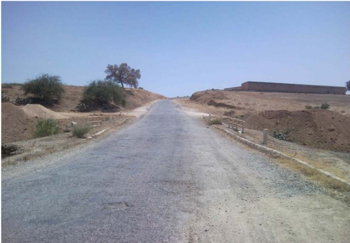
Photo N°02 : chaussée dégradée avec présence de nid de poule, absence Système de drainage des eaux.
