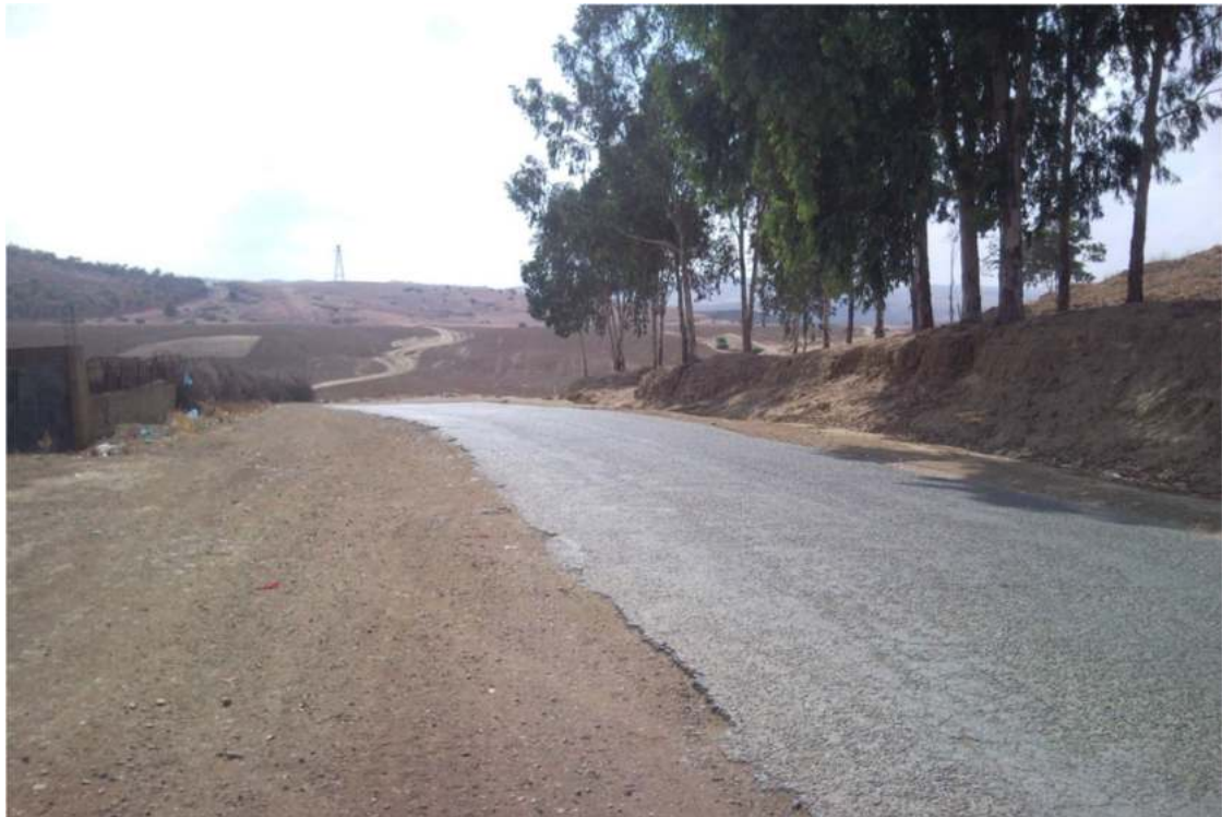
Photo N°01 : chaussée dégradée. Absence Système de drainage.
