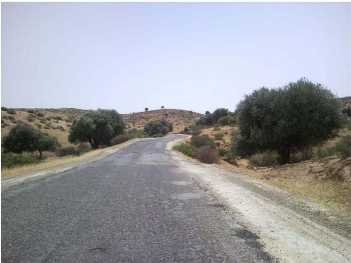
Photo N°03 : chaussée dégradée. Système de drainage des eaux superficielles non opérant présence
