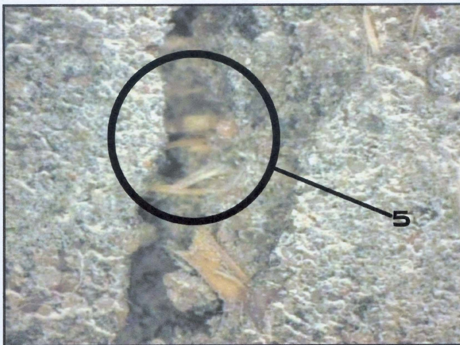
Photo 8: Vue rapprochée des fissures ainsi la présence des incuits
