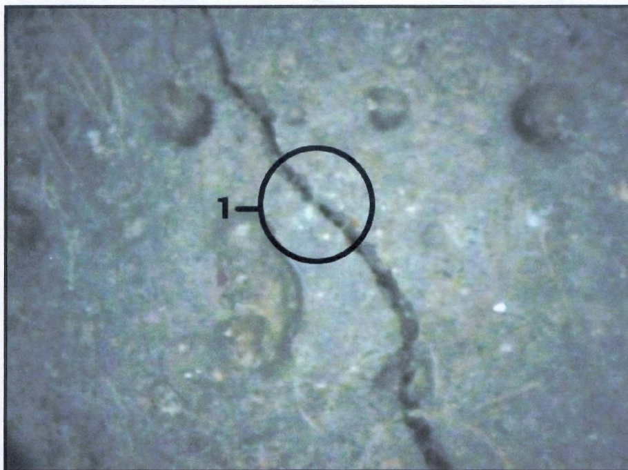
Photo 6: Vue de fissure (notons la continuité des fibres) motier1% (grossissement x25)
