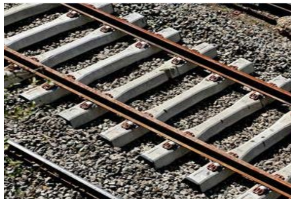
Figure.I.15.les rails et le traverses
