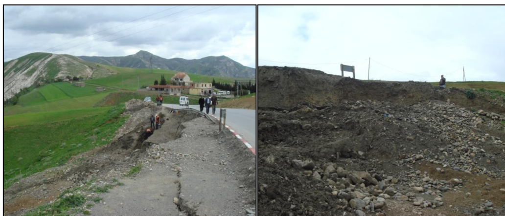
Figure II.5 : Escarpement en tête du talus
