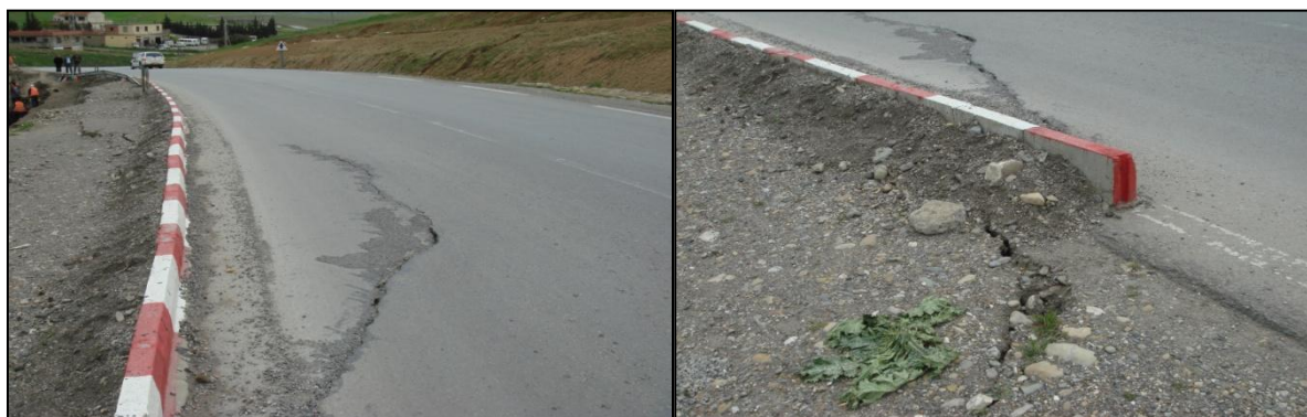
Figure II.3 : Affaissement et fissuration de la route
