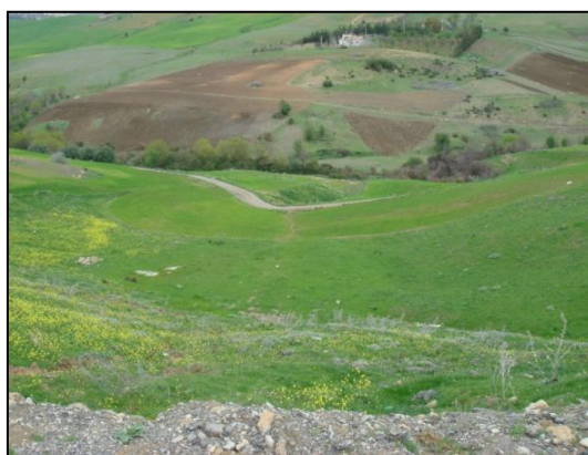
Figure II.2 : Dénivelé entre la chaussée et le pied du talus
