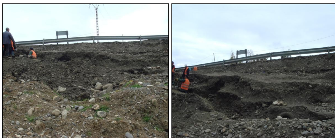
Figure II.1 : Escarpement en tête du talus
