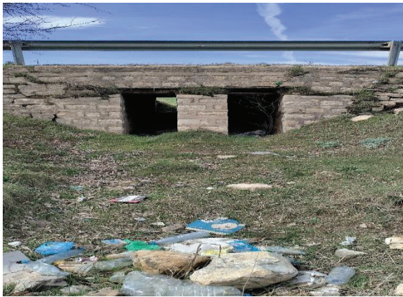
figure X.3 : OA PK 77+870 – 2X0.6X1.2 Structure disloquée
