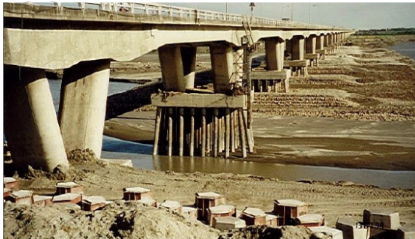
FIGURE IX.1 – Un exemple d'affouillement autour des piles de pont
