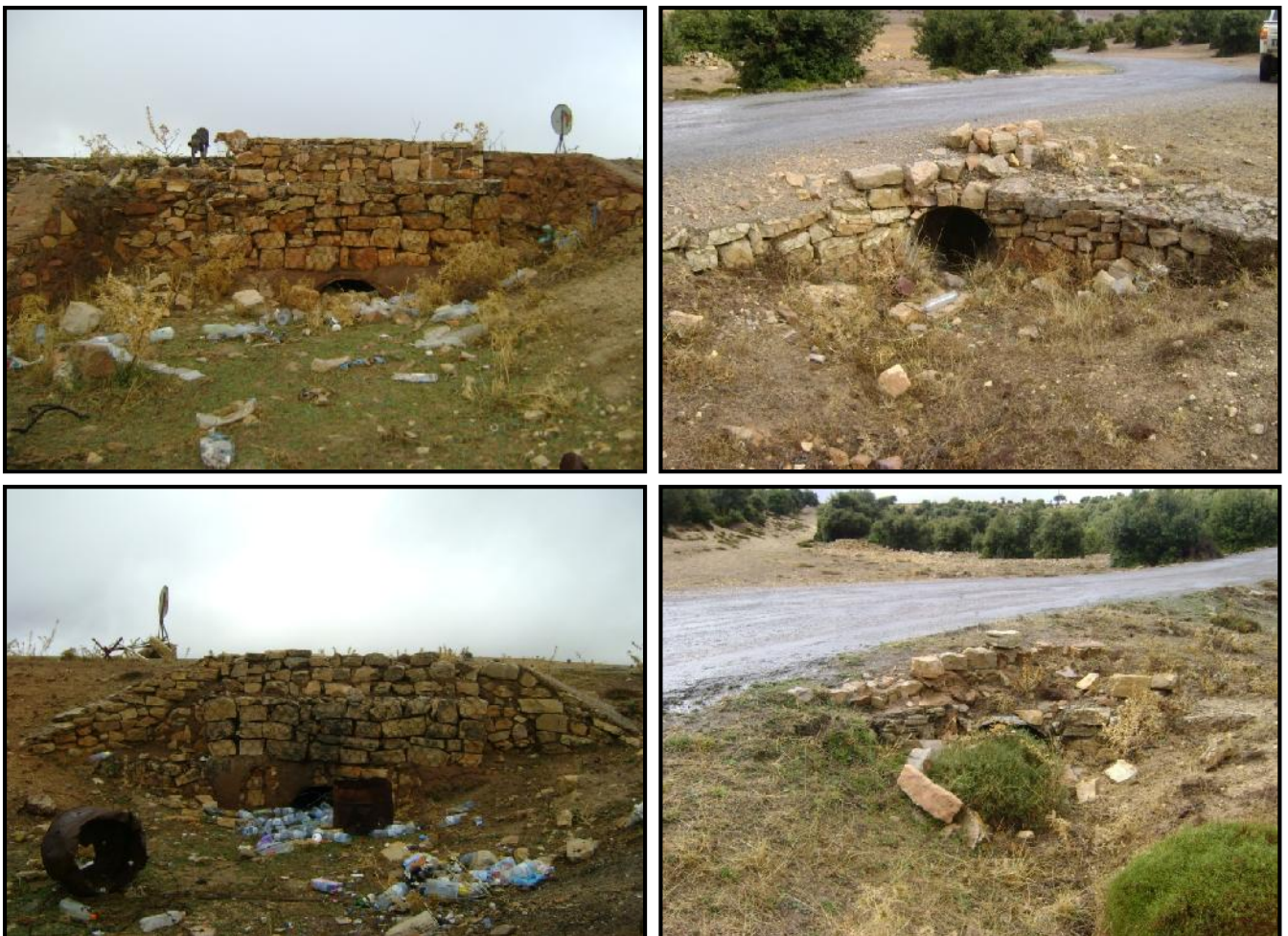
Fig. I.3.5.2 L'état des Ouvrages busé Ø600mm en maçonnerie.
