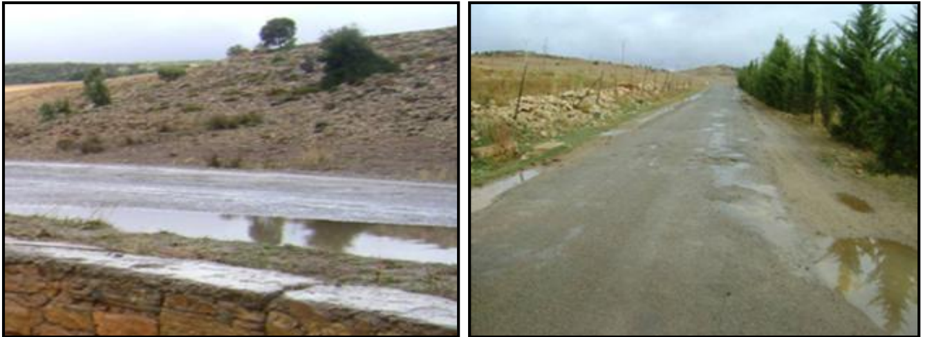
Fig. I.3.5 .I Absence des fossés.
