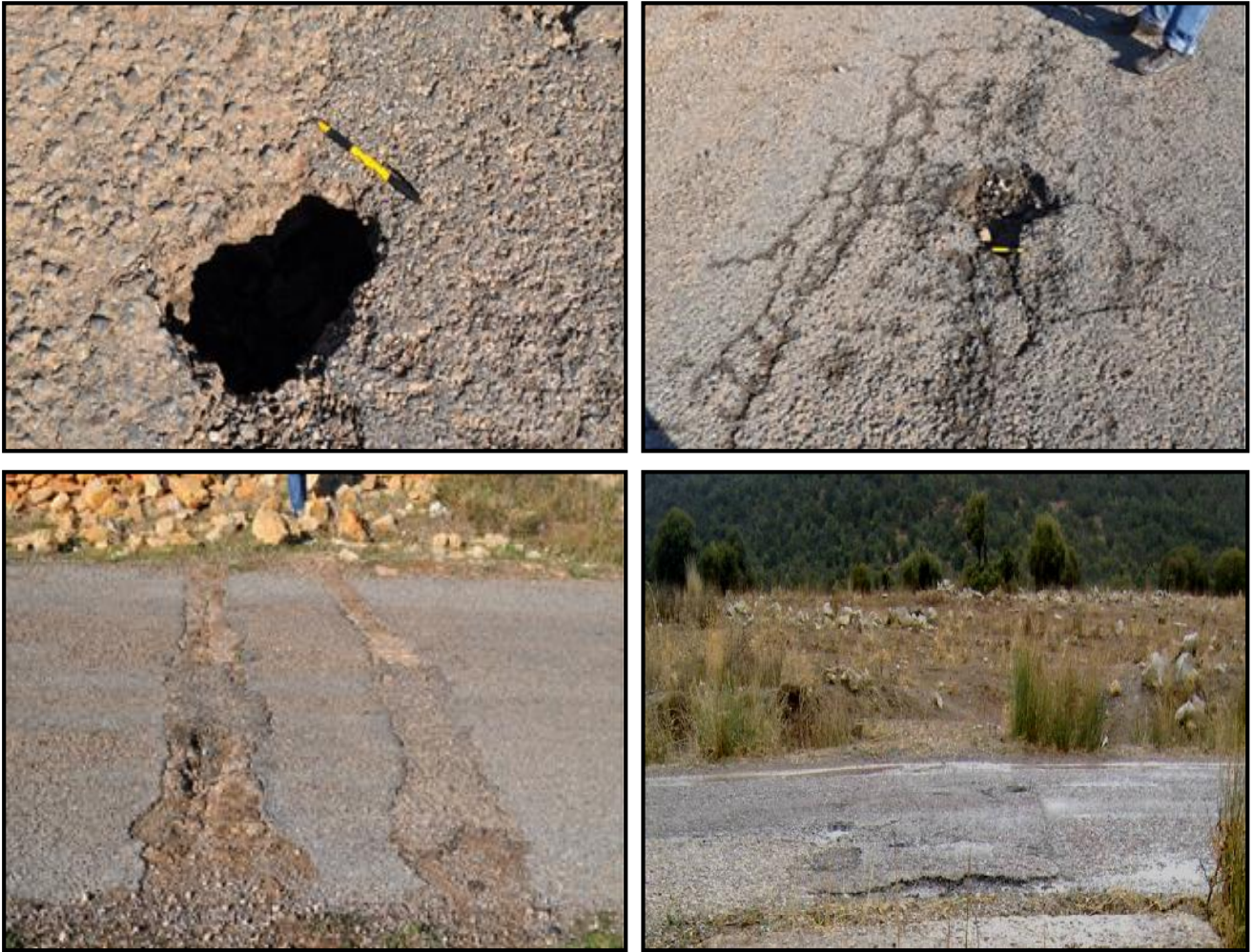
Fig. I.3.4 : Photos montrant l'état de dégradations de la chaussée actuelle. On mettra pour chaque type de dégradations ses photos.
