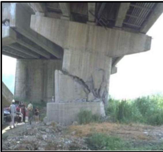
Figure1.6. Ruptures par cisaillement Chili 2010 [4]
