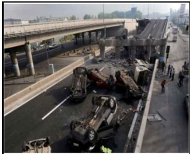
Figure1.7. Echappement d'appui au des piles [4]
