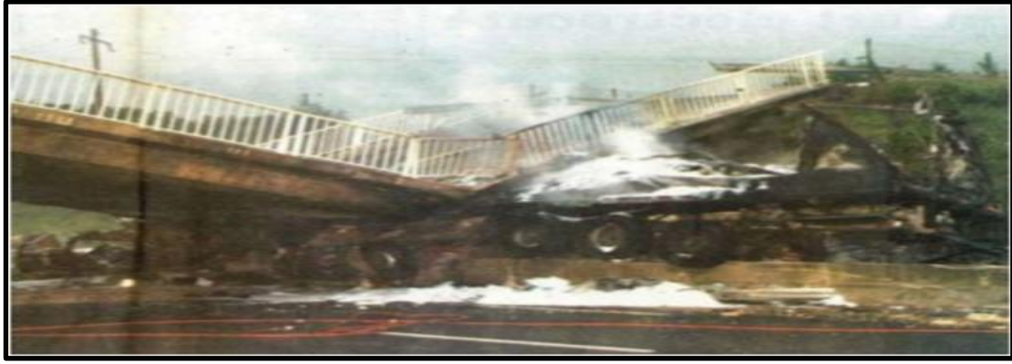
Figure I.8. Effondrement d'un pont lors d'un violent choc de poids lourd.[4]
