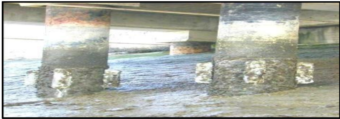
Figure I.4. Une attaque sulfatique sur les piles [2]
