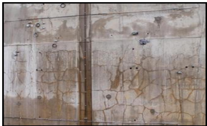
Figure I.3. Faïençage résultant d'une alcali-Réaction dans un mur[1]
