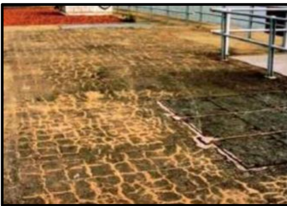
Figure I.2. Faïençage résultant d'une alcali-Réaction dans une dalle.[1]
