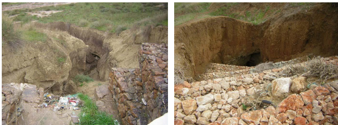
Figure I.9 : Problèmes d'érosion superficielle et souterraine aux sorties des dégâts de la RN6
