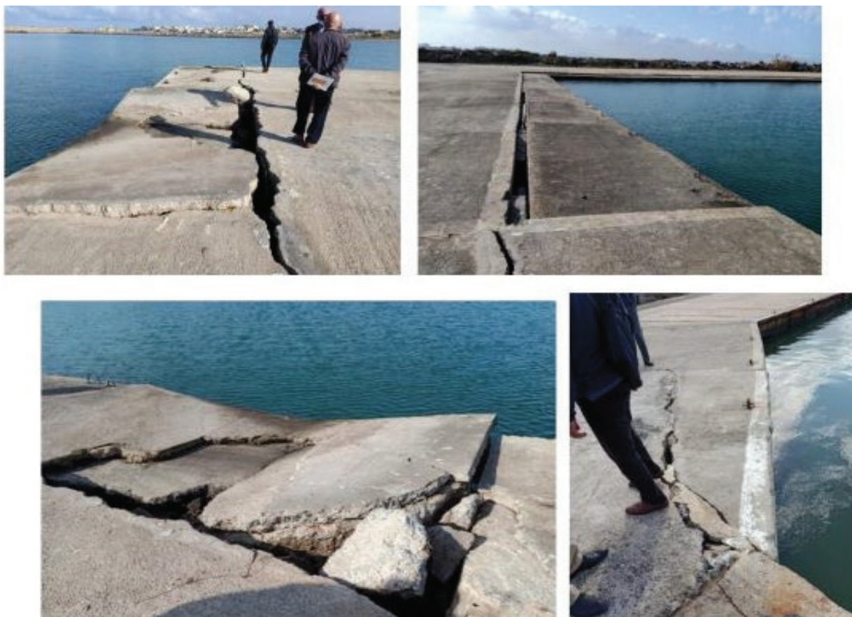
figure 9. Photos représentant l'état actuelle du quai
