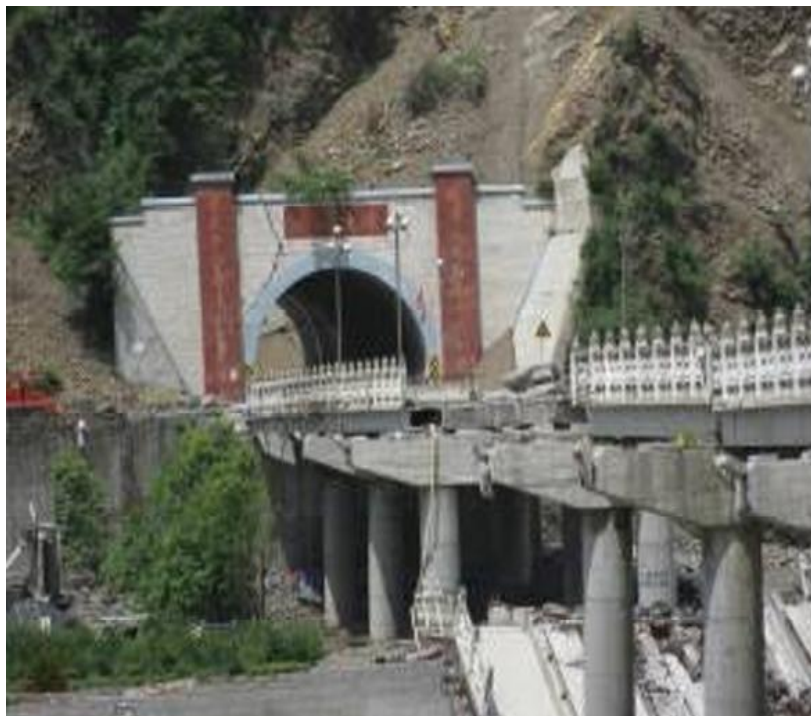
Figure I.6: Exemples de mécanismes de rupture au niveau des portails (Failure of tunnel slope, Wang et al., 2009).
