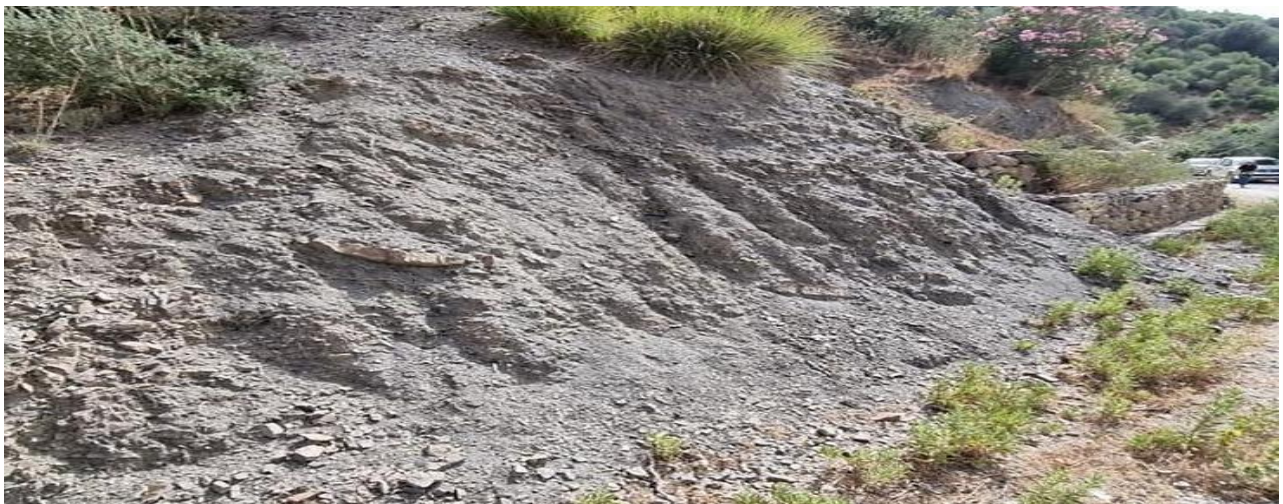
Figure III.43: Zone altérée et matériaux meubles au niveau du front
