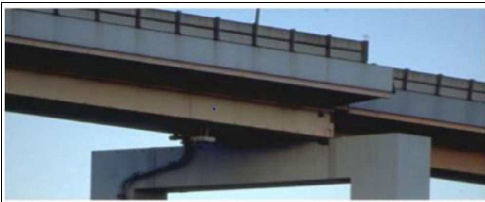
Figure XI. 2 Déplacement latéral du tablier et chute des appuis sur la palée d'un pilier à Kobe en 1995
