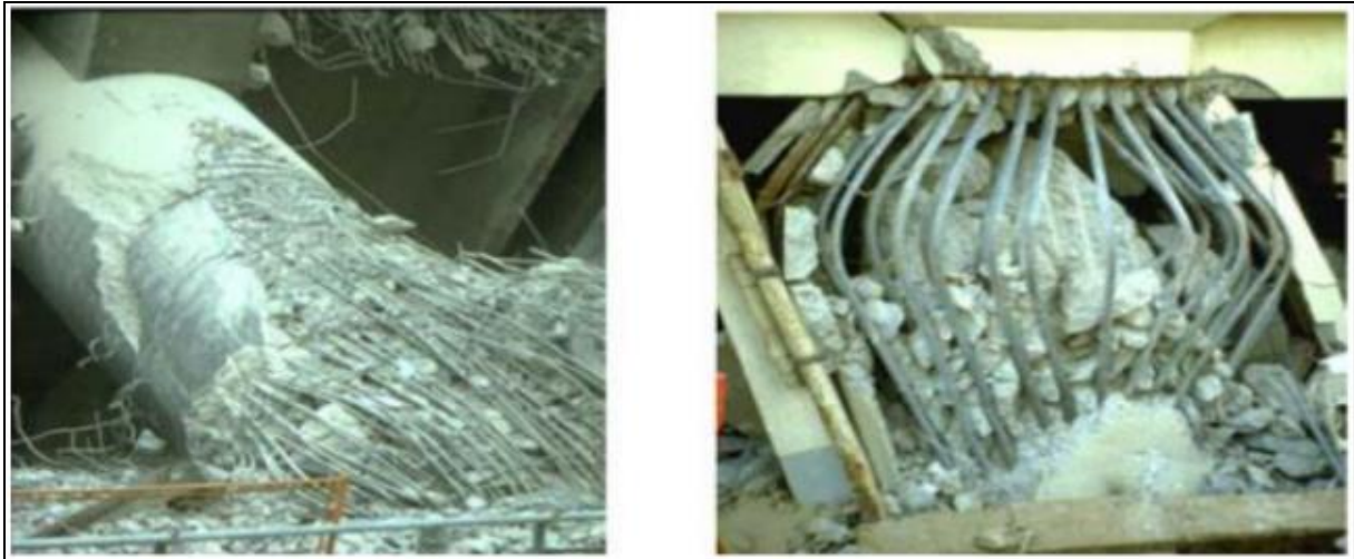
Figure XI. 5 Ruine de piles de pont en béton armé lors du tremblement de terre de Kobe en 1995.
