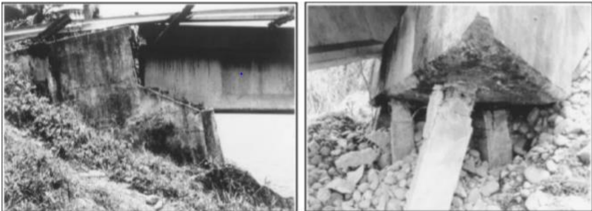
Figure XI. 4 Endommagement des culées (Source : Moehle, J.P., Eberhard, M.O, 2000)
