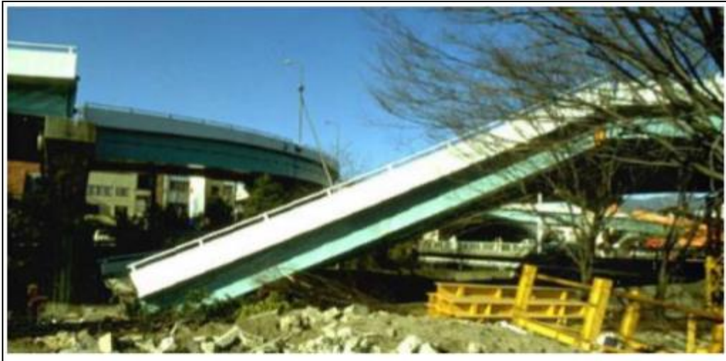
Figure XI. 1 Chute du tablier d'un pont lors du tremblement de terre de Kobe en 1995
