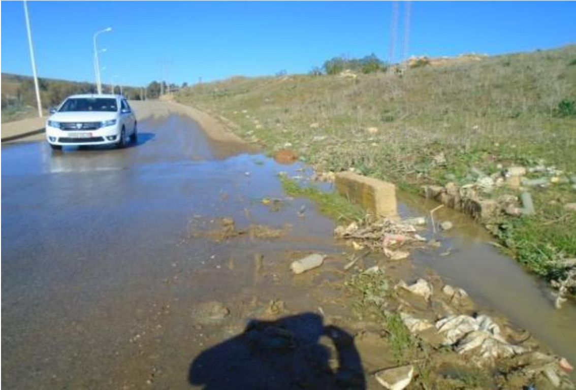
Figure I-15: Stagnation des eaux sur la route
