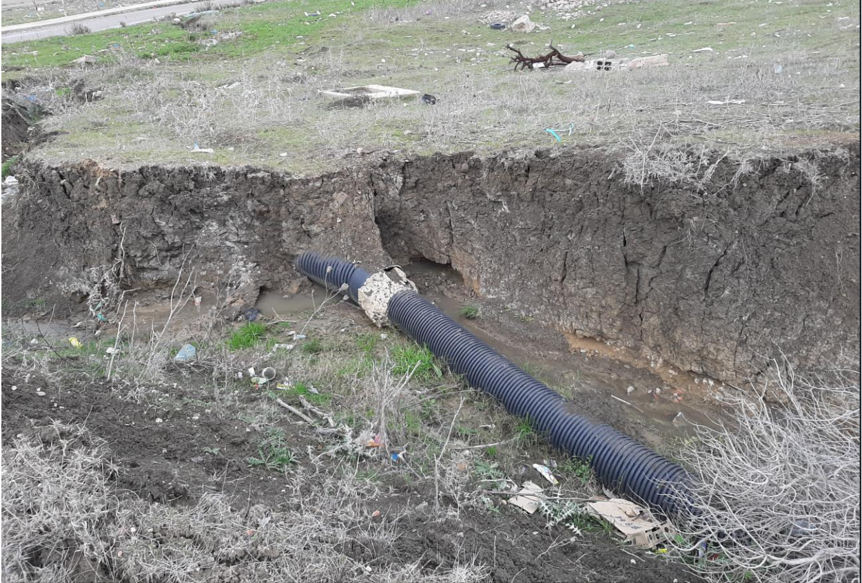
Figure I-12:Le réseau d'assainissement est apparu par suite du glissement
