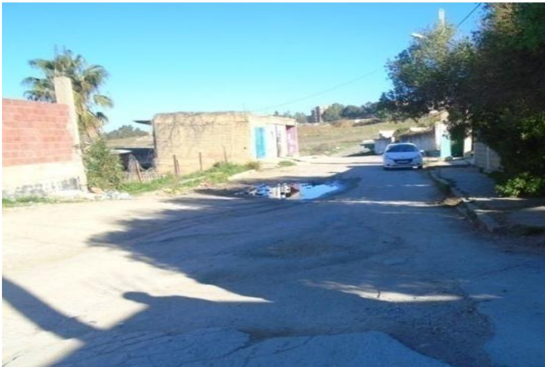
Figure I-16: Affaissement de la route et stagnation d'eau
