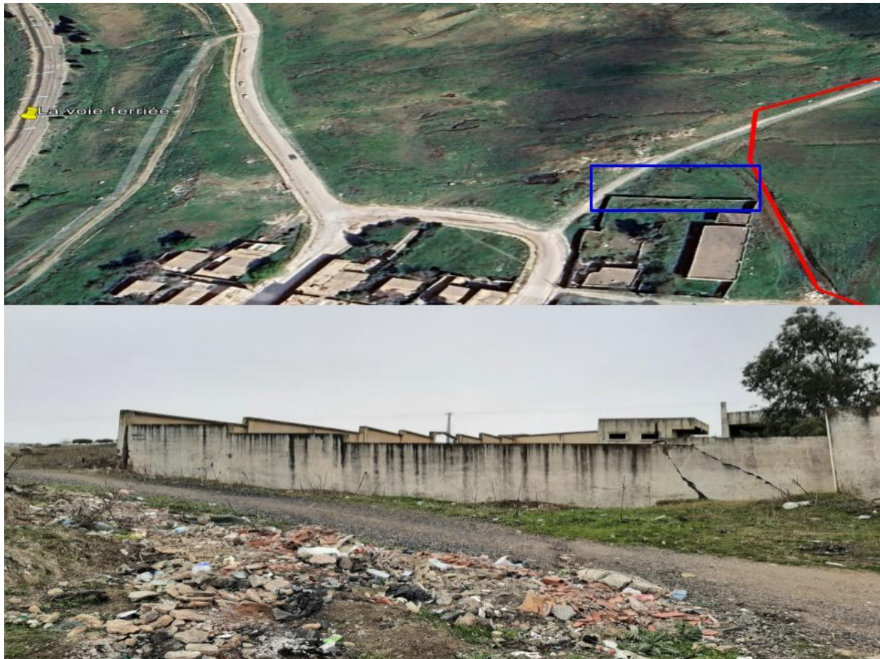
Figure I-10: Basculement d'un mur dans 104 log (36°26'15.74"N 6°38'16.22"E)
