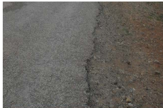
Figure II.10 : Photo sur l'arrachement de type épaufrure
