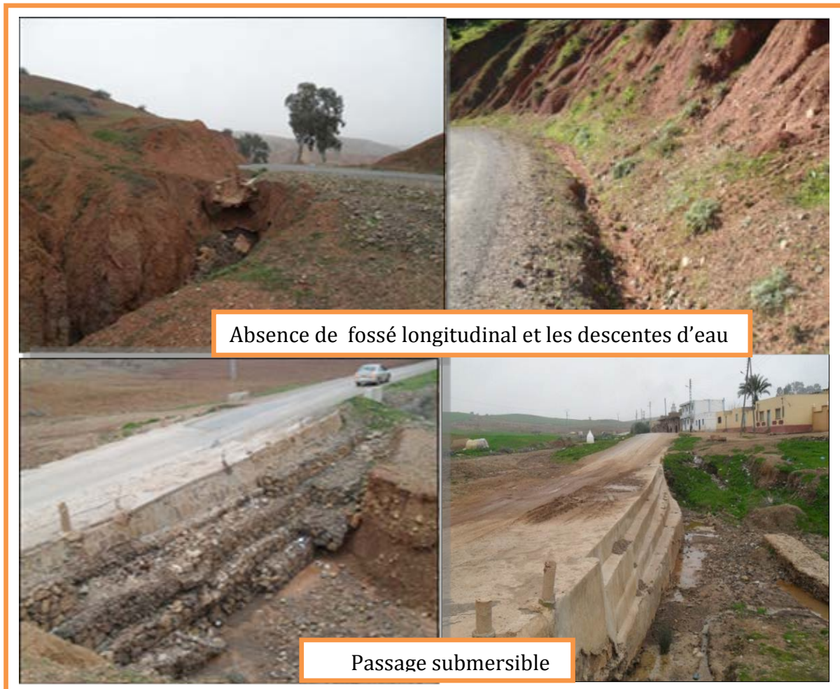
Figure II.13 : Etat de l'assainissement de l'ancienne route
