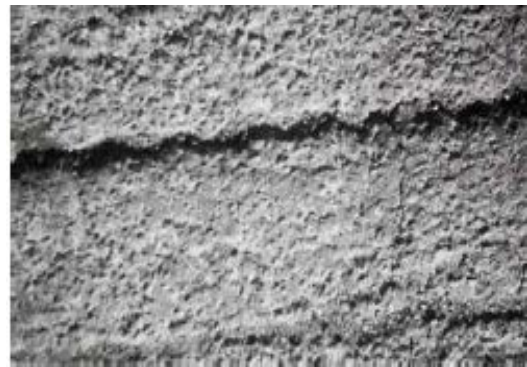
Figure II.11 : les fissures longitudinales et transversales
