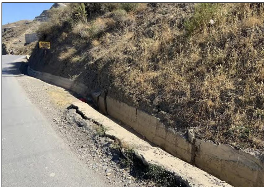
Figure III-10 : Déformation du canal de drainage en béton de la route nationale RN77
