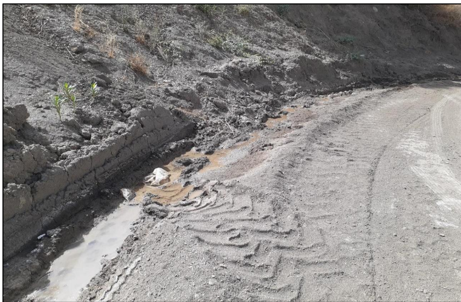
Figure III-9 : Suintement d'eau en pied de versant
