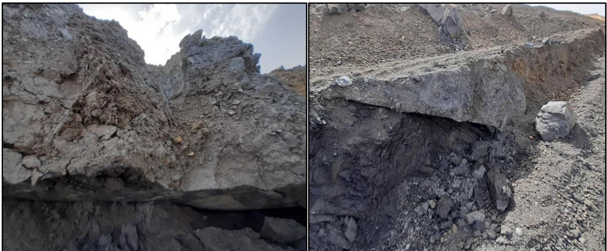
Figure III-7 : Vue rapprochée du plan de cisaillement au contact avec la plateforme autoroutière
