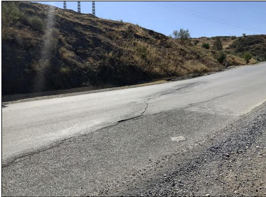
Figure III-11 : Fissures transversal sur la chaussée de la RN77
