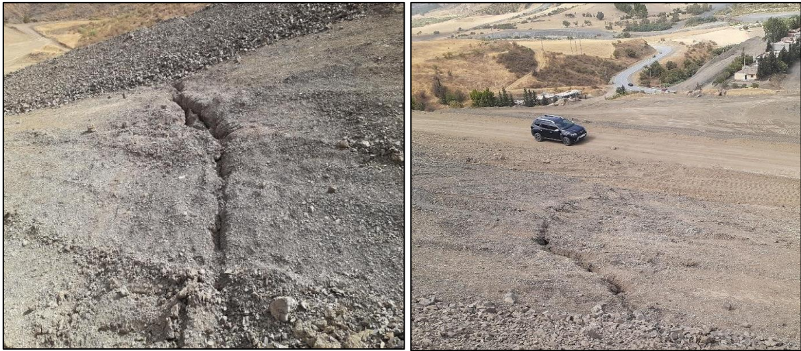
Figure III-8 : Exemple de fissure dans les talus de déblai (sud-est)
