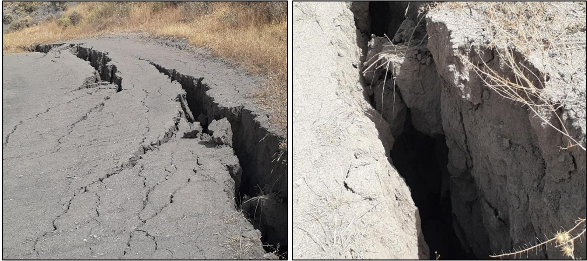
Figure III-5 : Vue rapprochée des fissures ouvertes au sommet de la zone de glissement
