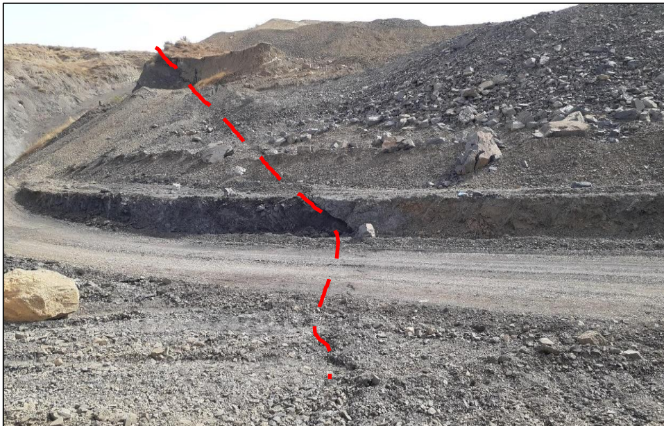
Figure III-6 : Fissure traversant la plateforme autoroutière — limite nord du glissement
