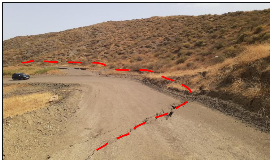
Figure III-4 : Vue du sommet de la zone de glissement — fissure ouverte
