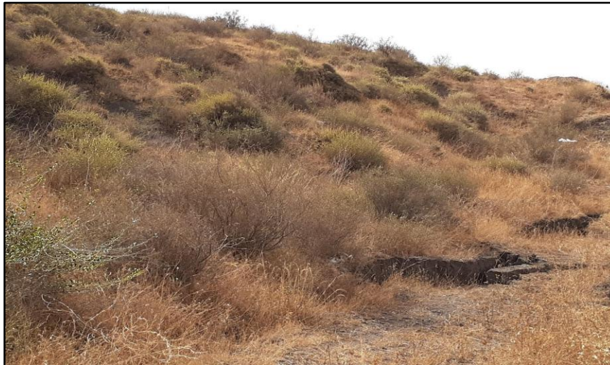
Figure III-3 : Pente abrupte de l'escarpement principal — fissure ouverte en pied de l'escarpement
