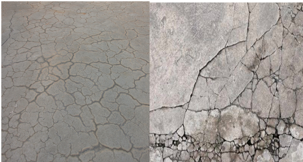
Figure I. 1 Ouvertures importante des fissures de retrait.
