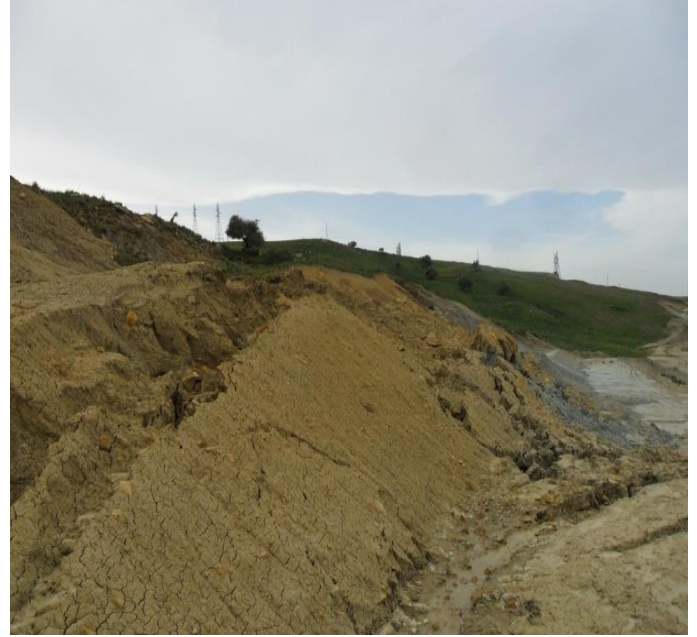
Figure III.4: Déferlement des argiles sableuses
