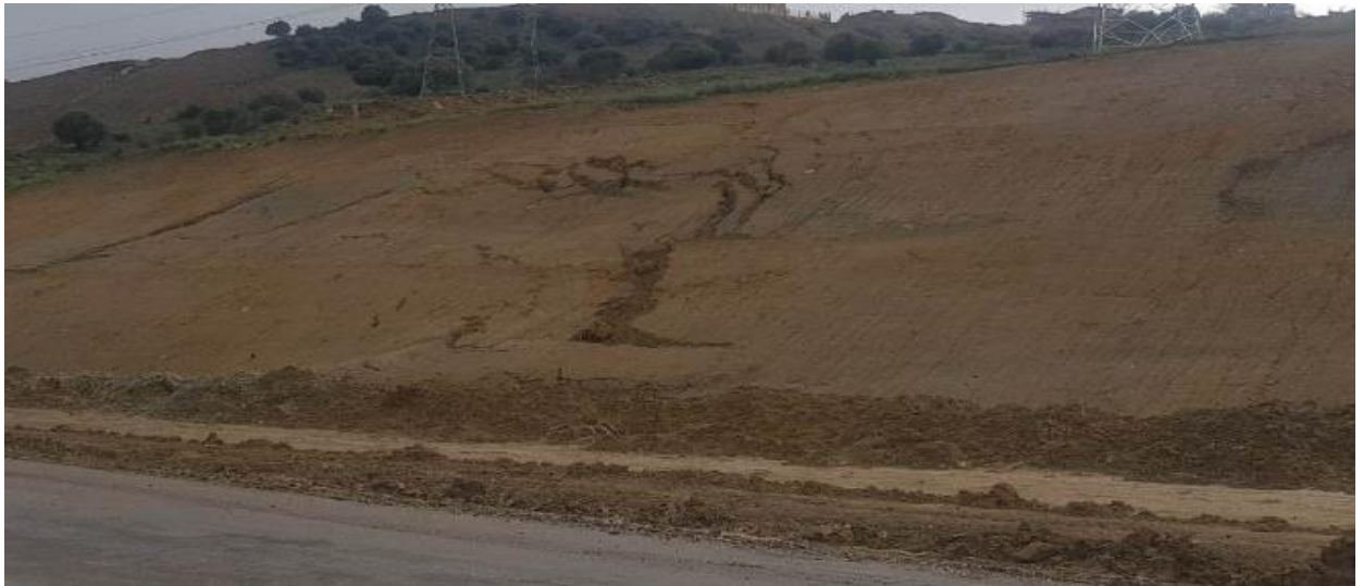
Figure III.5: Présence de fissuration dans le talus
