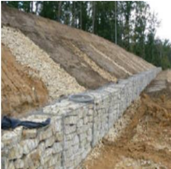
Figure I.15: Exemple d'éperons drainants
