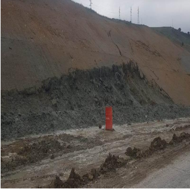
Figure III.3: Etat du pied du talus
