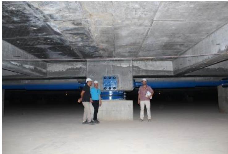
Figure I-5 : Isolateurs sismiques utilisé dans la grande mosquée d'Alger
