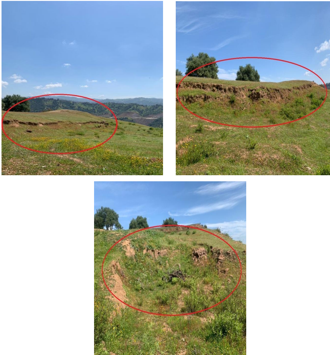
Figure 2-10: Présence des affaissements au milieu du talus
