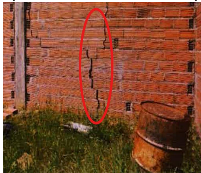
Figure 2-15: Les fissures au niveau des murs des bâtisses
