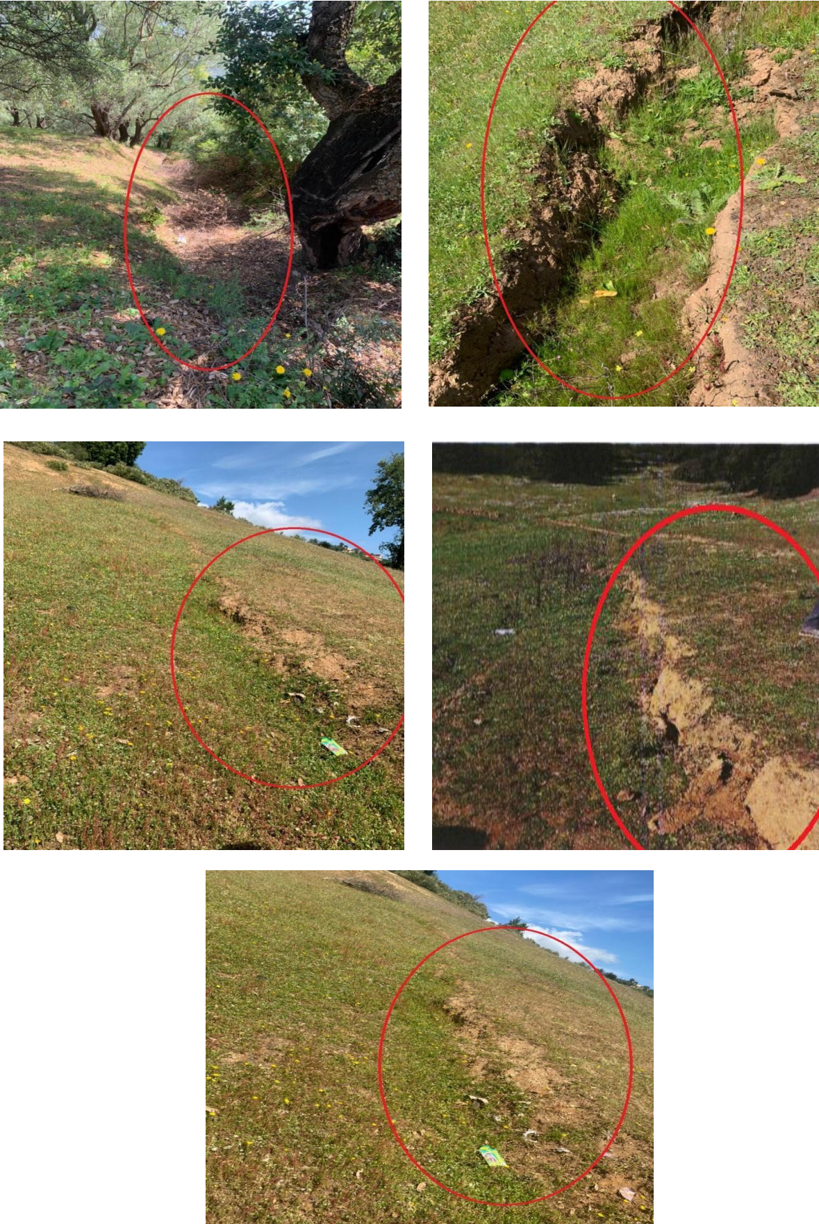
Figure 2-11: Présence des escarpements en tête et des ruptures dans la partie supérieure du sol
