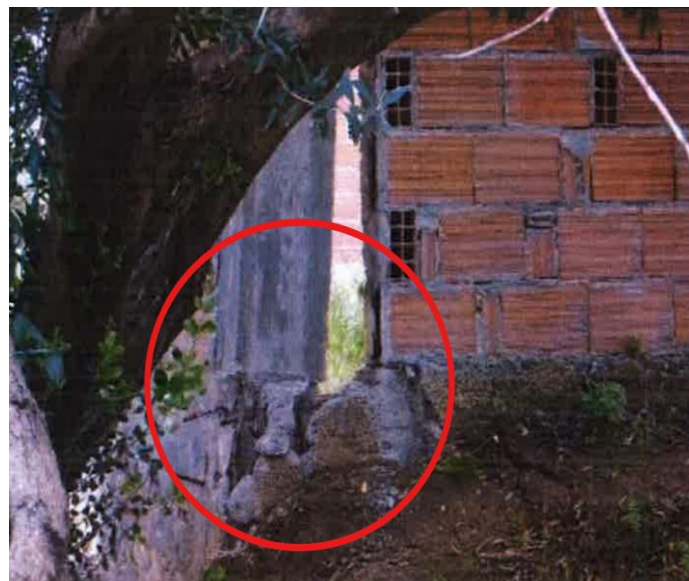
Figure 2-14: Les éléments structurels endommagés
