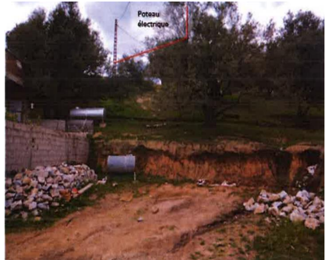
Figure 2-13: Zone d'habitation endommagée
