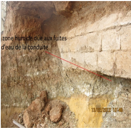
Figure 50 Etat d'ovoïde sous la chaussée
