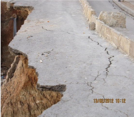
Figure 52 Etat de la chaussée après glissement
