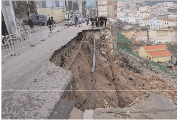
Figure 54 vue latérale du glissement
