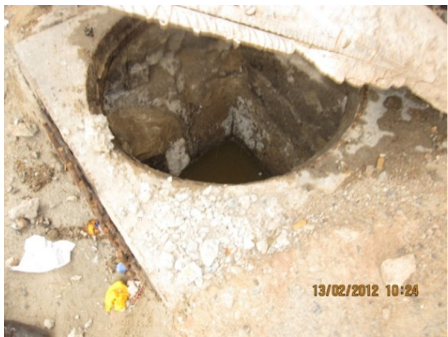
Figure 49 Fissuration et obstruction du réseau
