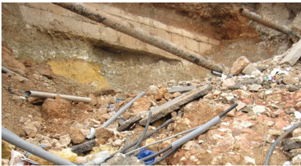
Figure 48 Etat du réseau d'assainissement
