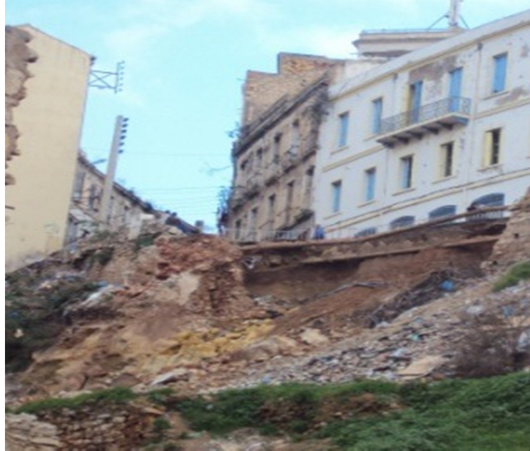
Figure 47 Etat actuel du site [Source photo prise lors de la visite du site]
