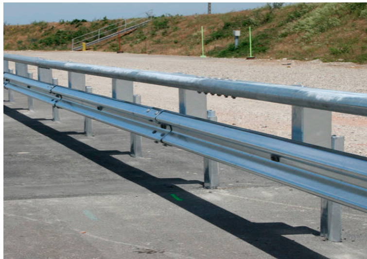
FIGURE 8.11 – Glissières de sécurité
