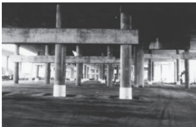
Figure I. 7 Vestes en acier et poutre de liaison - Santa Monica Freeway.
