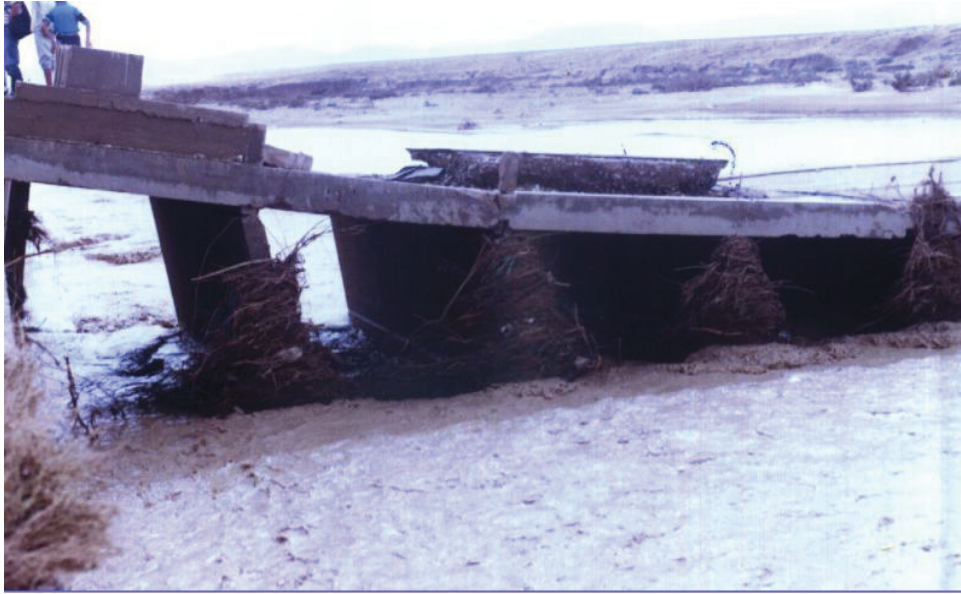
Figure Erreur ! Il n'y a pas de texte répondant à ce style dans ce document..6.l'effondrement du pont enjambant Oued Barika
