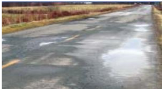
FIGURE 5 AFFAISSEMENT DE LA CHAUSSEE
