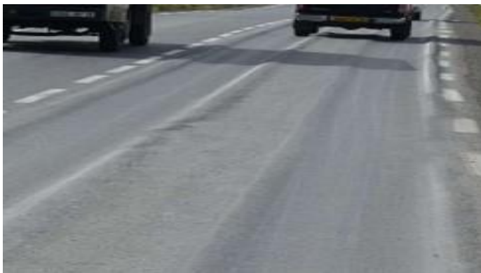
FIGURE 4 ORNIERAGE DE LA CHAUSSEE
