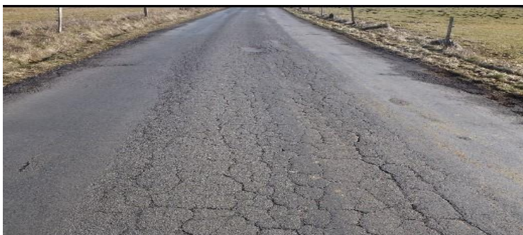
FIGURE 3 FAÏENÇAGE DE LA CHAUSSEE
