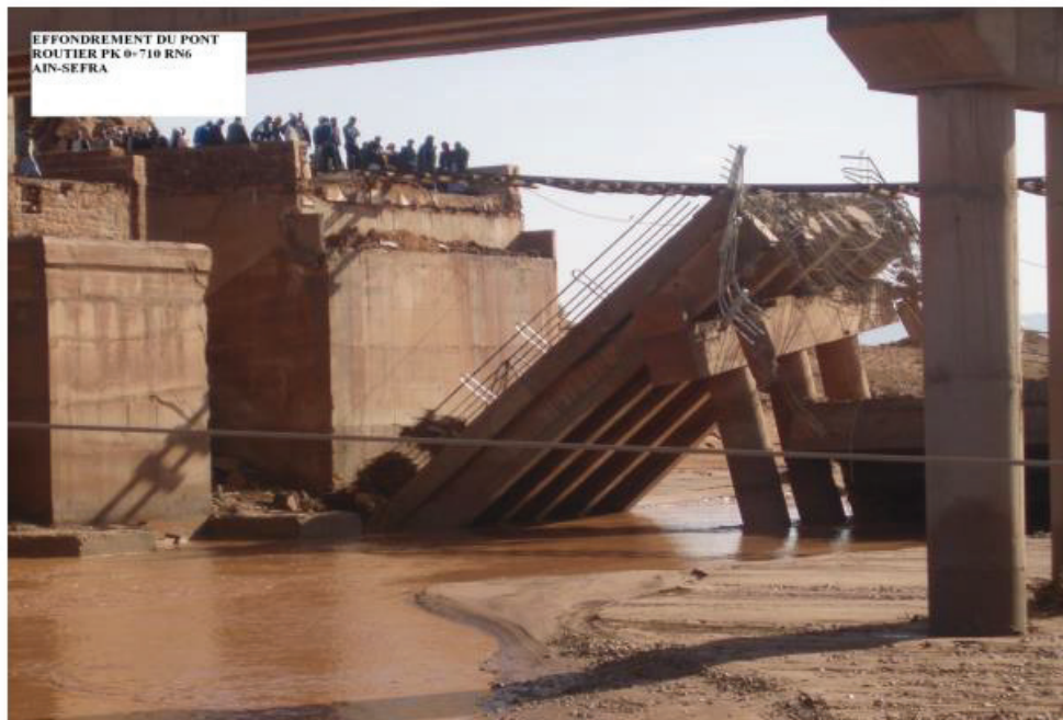
Figure I. 8 Effondrement du pont routier à PK 0+710 RN6 –Ain Sefra
