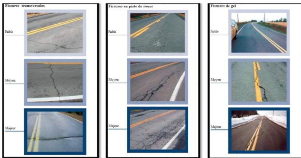
Figure I.8: Dégradation des chaussées par fissuration.
