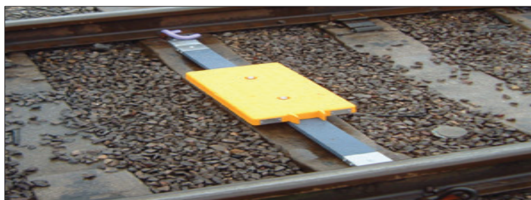
Figure XIII. 2: Une balise installée sur la voie
