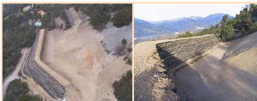
Photo.III.17. Protection contre les glissements de terrain en grande masse
