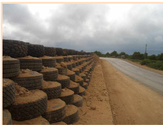
Photo.III.11. Stabilité d'un talus – Cas de Mostaganem
