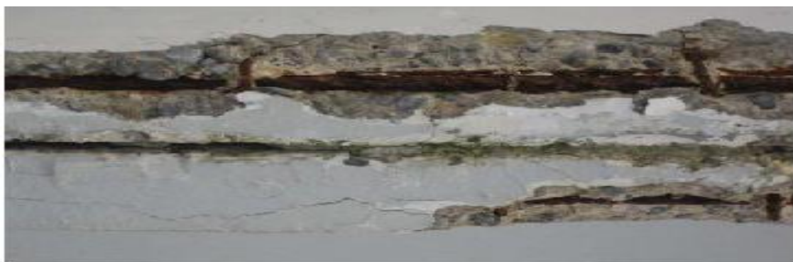
Figure I-1: L'état de corrosion des armatures (Par carbonatation) sur une poutre en béton armé.
