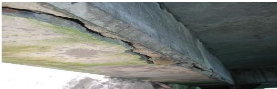
Figure I-2:Fissuration du béton d'une poutre due au gonflement des armatures.
