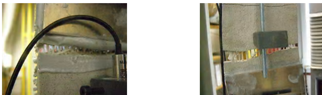
Figure 5.2.3 rupture des TRC à fibre de verre (E, AR).
